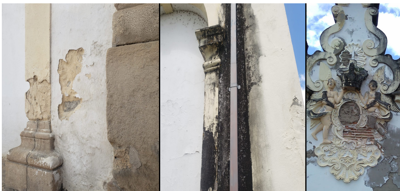
Figura 6 Exemplo de patologias da fachada principal da igreja: fissuras, mancha negra e descolamentos. Fonte: Os autores.
